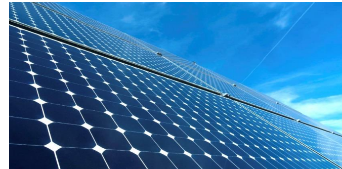
Solar panel/ PV module
